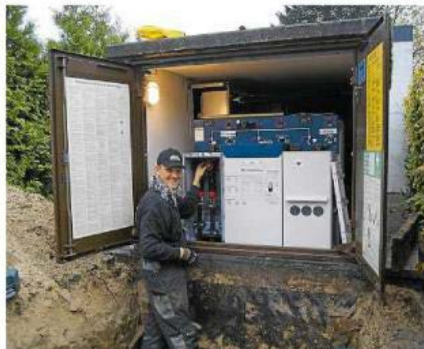
Rund eine halbe Stunde blieben am späten Mittwochabend Telgte und Westbevern ohne Strom. Mit ursächlich für den Ausfall war neben einem Kabelfehler die Trafostation an der Daimlerstraße, die gestern repariert wurde. Foto: Große Hüttmann
