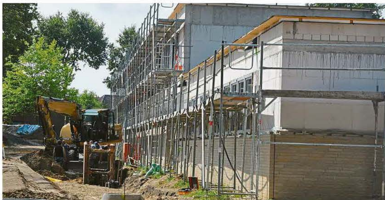
Nicht nur an der Wache, sondern auch im Außenbereich bei der Kanalisation wird derzeit mit Hochdruck gearbeitet.
