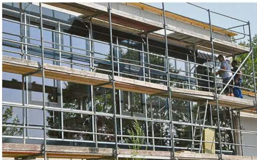
Die Fenster werden derzeit eingebaut: Riesige Flächen sind im „Mannschaftsbereich“ bereits fertiggestellt.
